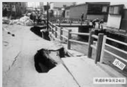
被災状況（平成 6 年 9 月 24 日）
