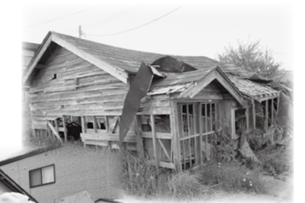
危険な状態にある家屋等を放置していると、強風等によりトタンや外壁等が飛散する恐れがあり、大変危険です。
