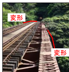
第一白川橋りょうの変形
