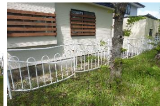
中央地区遊園地：老朽化したフェンス
