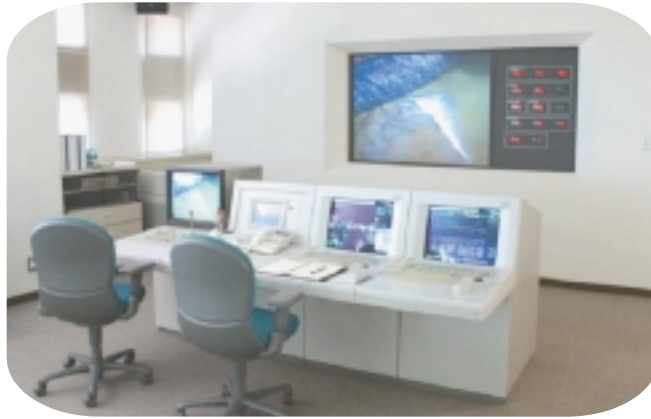
上水道管理センター集中監視システム
