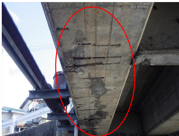
図3-5 主桁に発生した塩害による損傷事例
