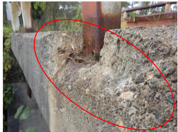
図3-6 地覆に発生した凍害による損傷事例
